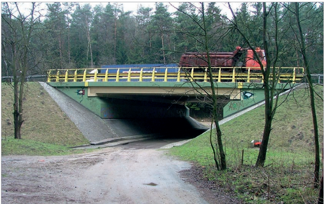
Fot. 79. Przykład przejścia dolnego z niewłaściwie ukształtowanymi skarpami przyczółków – droga ekspresowa S-6.
