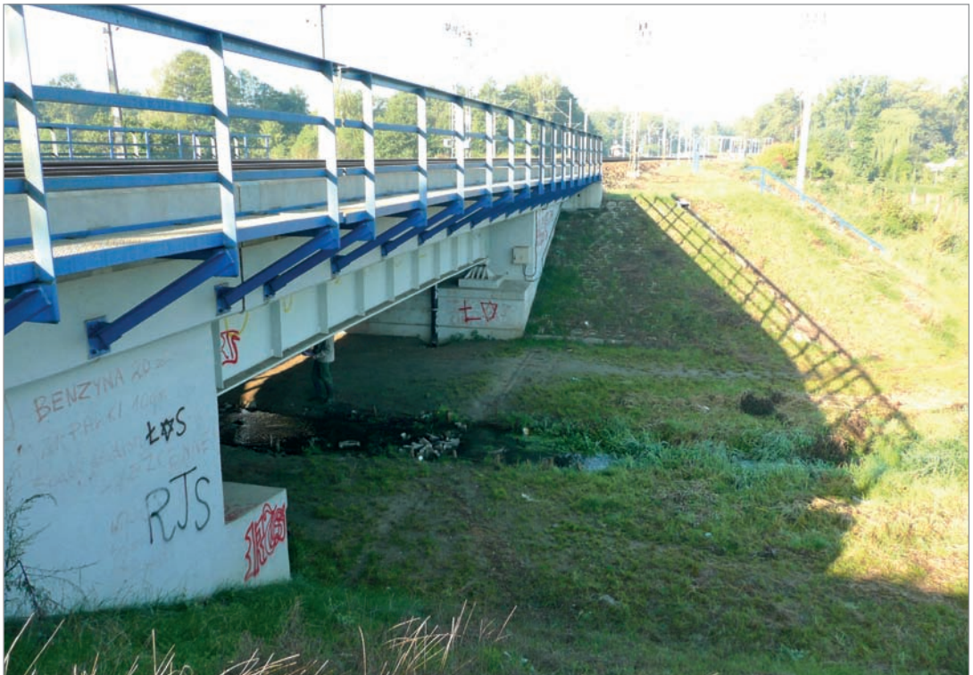
Fot. 164. Przejście dolne dla średnich zwierząt pod poszerzonym mostem przy linii kolejowej Warszawa–Łódź.
