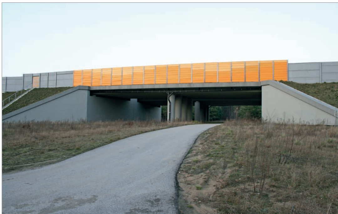
Fot. 90. Niekorzystne rozwiązanie – droga asfaltowa zlokalizowana na powierzchni przejścia dolnego – autostrada A2.
