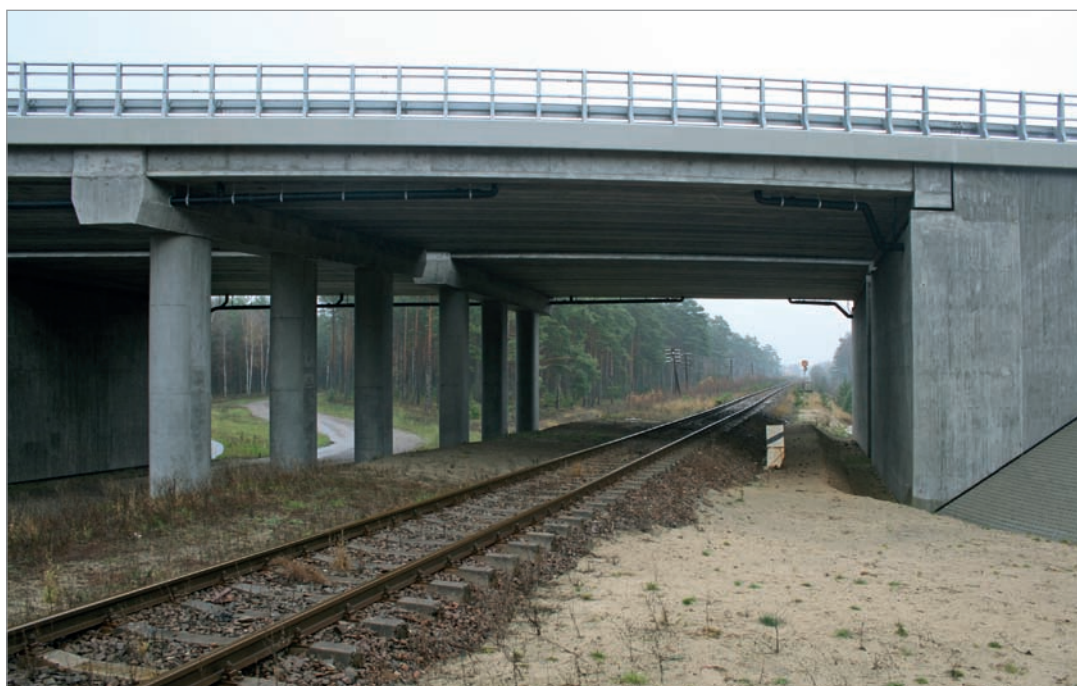
Fot. 99. Brak izolacji powierzchni przejścia od linii kolejowej powoduje zwiększone ryzyko kolizji z udziałem zwierząt – autostrada A1.
