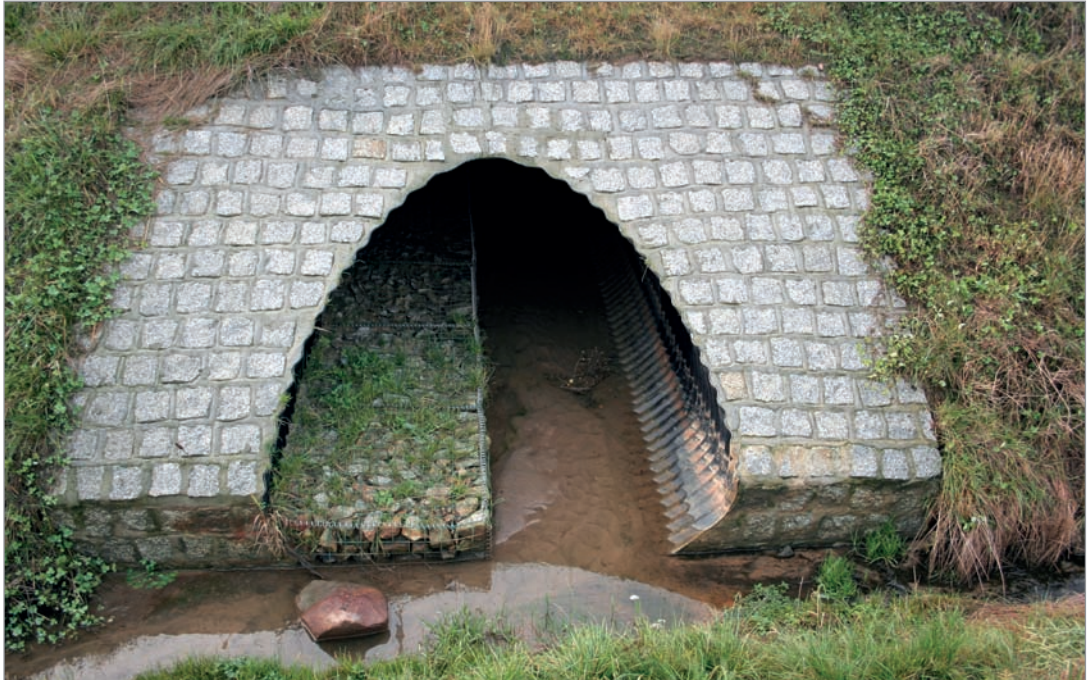
Fot. 97. Półka wykonana z gabionów bez pokrycia gruntem, bez połączenia z otaczającym terenem – autostrada A1.
