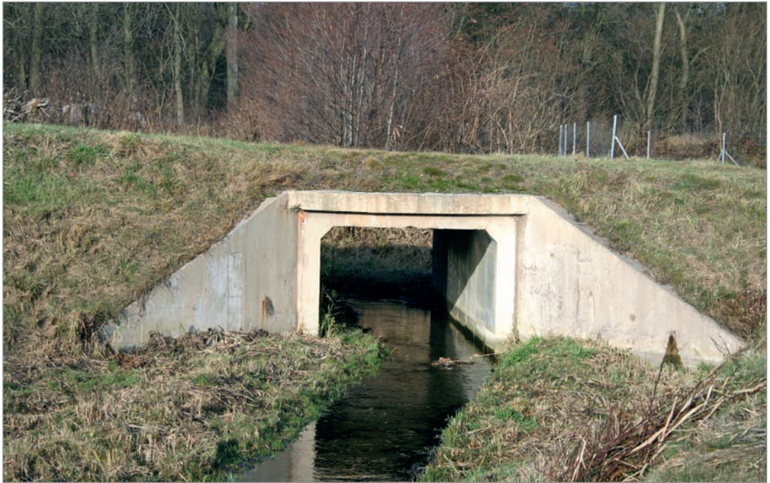
Fot. 52. Przejście dla małych zwierząt zespolone z rowem – przepust żelbetowy – droga serwisowa wzdłuż autostrady A2.
