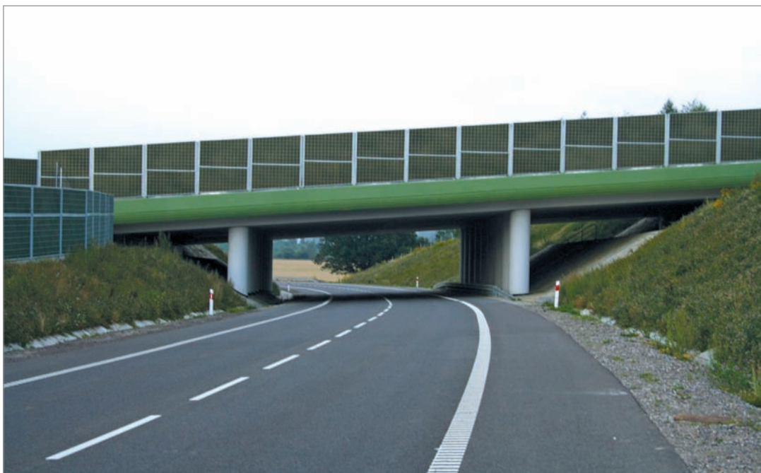
Fot. 139. Ekran typu „zielona ściana” na powierzchni przejścia górnego.
