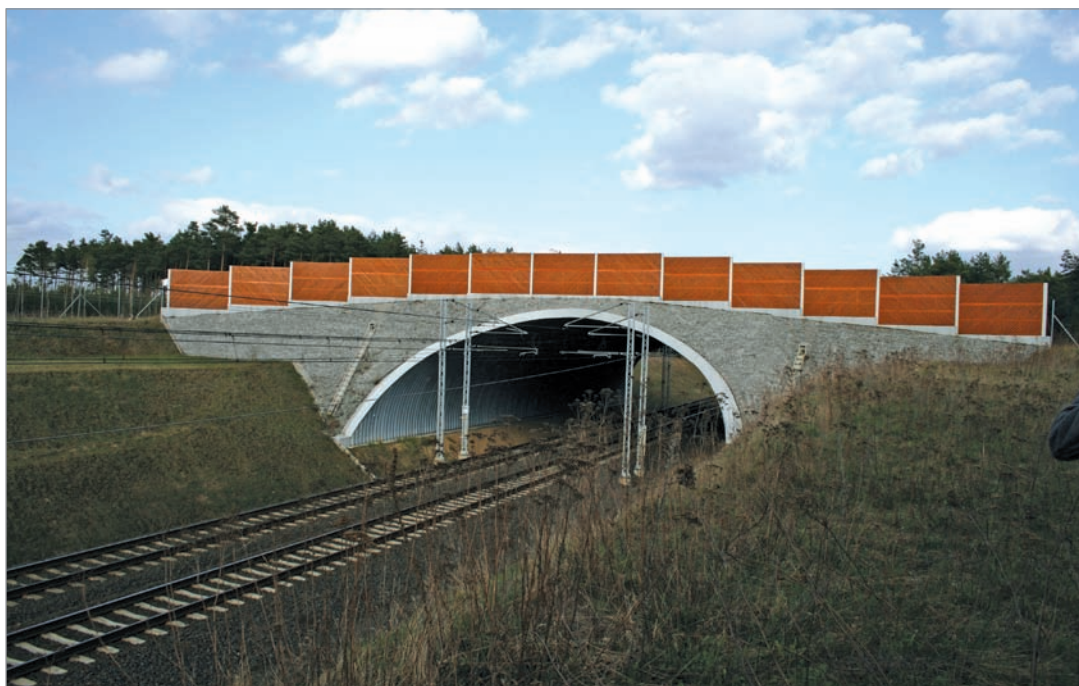
Fot. 160. Przejście górne dla dużych zwierząt przy linii E20 – zastosowano parametry i rozwiązania projektowe konstrukcji analogiczne jak w przypadku obiektów drogowych.
