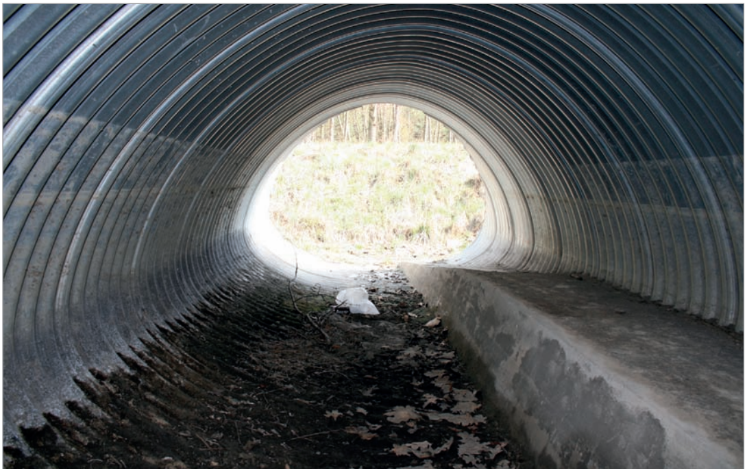
Fot. 98. Półka betonowa bez pokrycia gruntowego, kończąca się w dnie rowu – droga ekspresowa S-5.
