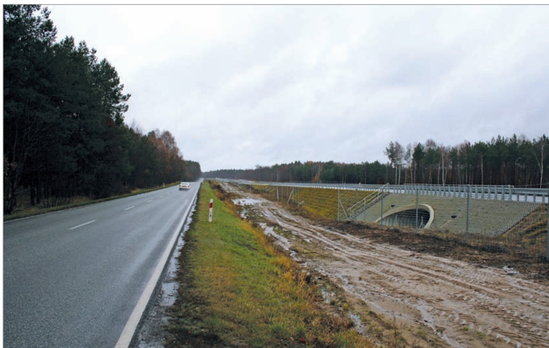
Fot. 111. Niedopuszczalne rozwiązanie – wylot z przejścia dolnego bezpośrednio na drogę publiczną o dużym natężeniu ruchu – droga ekspresowa S-3, droga krajowa nr 3.
