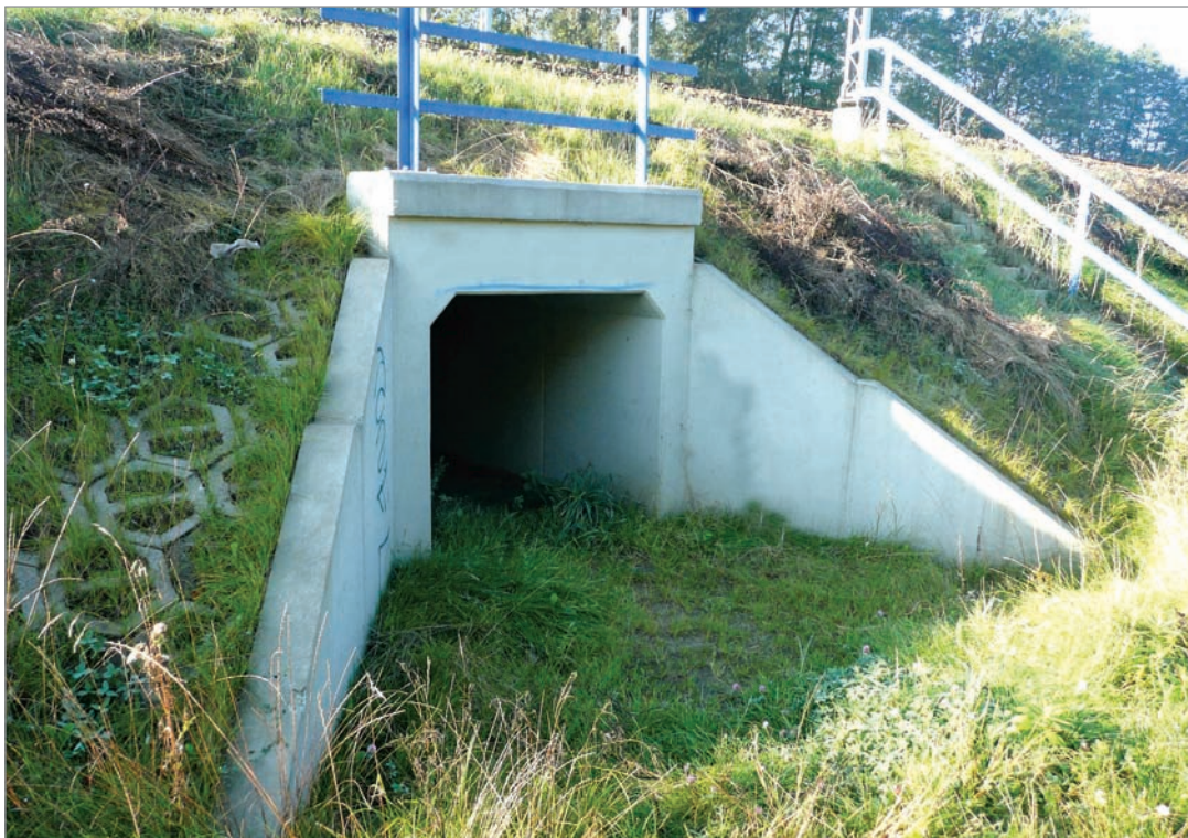
Fot. 161. Przejście dolne samodzielne dla małych zwierząt przy linii kolejowej Warszawa – Łódź.
