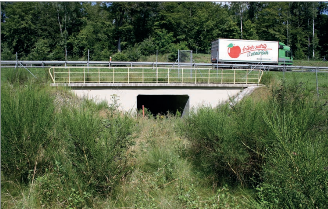
Fot. 48. Przejście dla małych zwierząt – przepust żelbetowy – autostrada A4.
