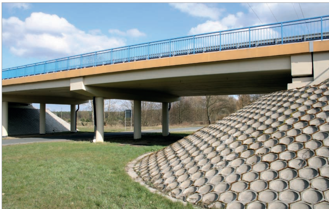
Fot. 100. Niekorzystne rozwiązanie – umacnianie skarp w strefach dostępnych dla zwierząt przy pomocy materiałów betonowych – droga krajowa nr 11.
