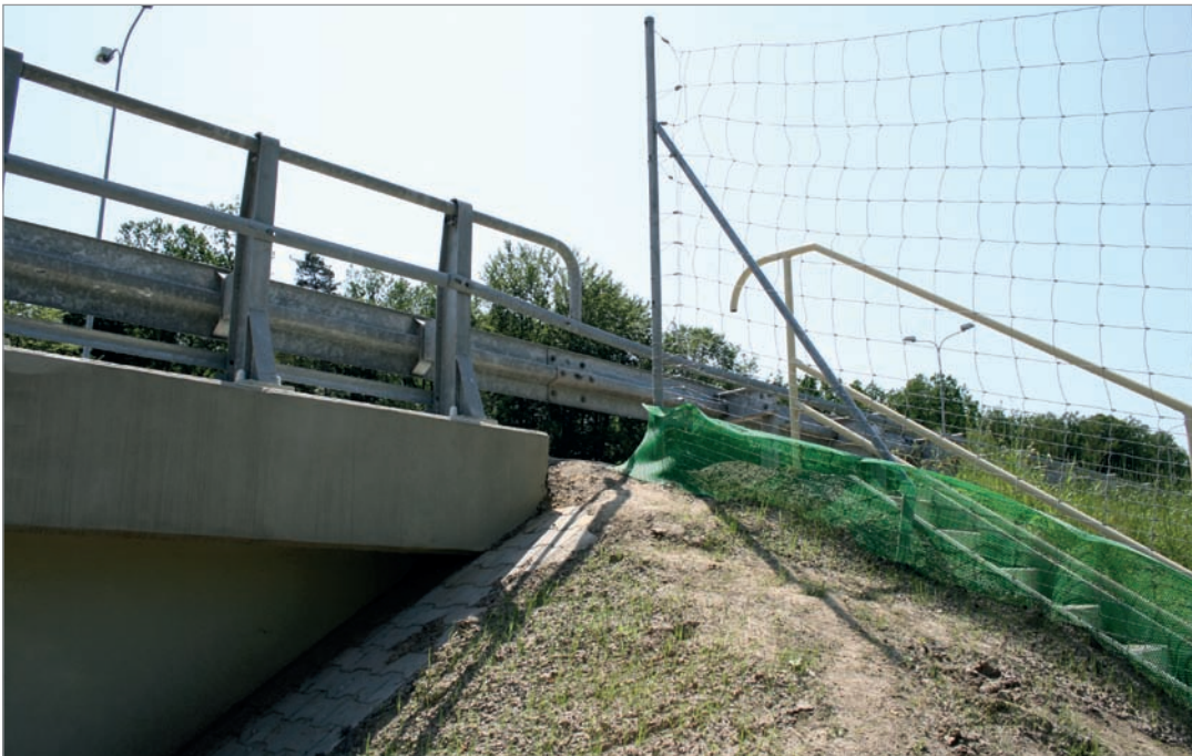
Fot. 134. Nieszczelne połączenie ogrodzeń z przejściem dolnym.
