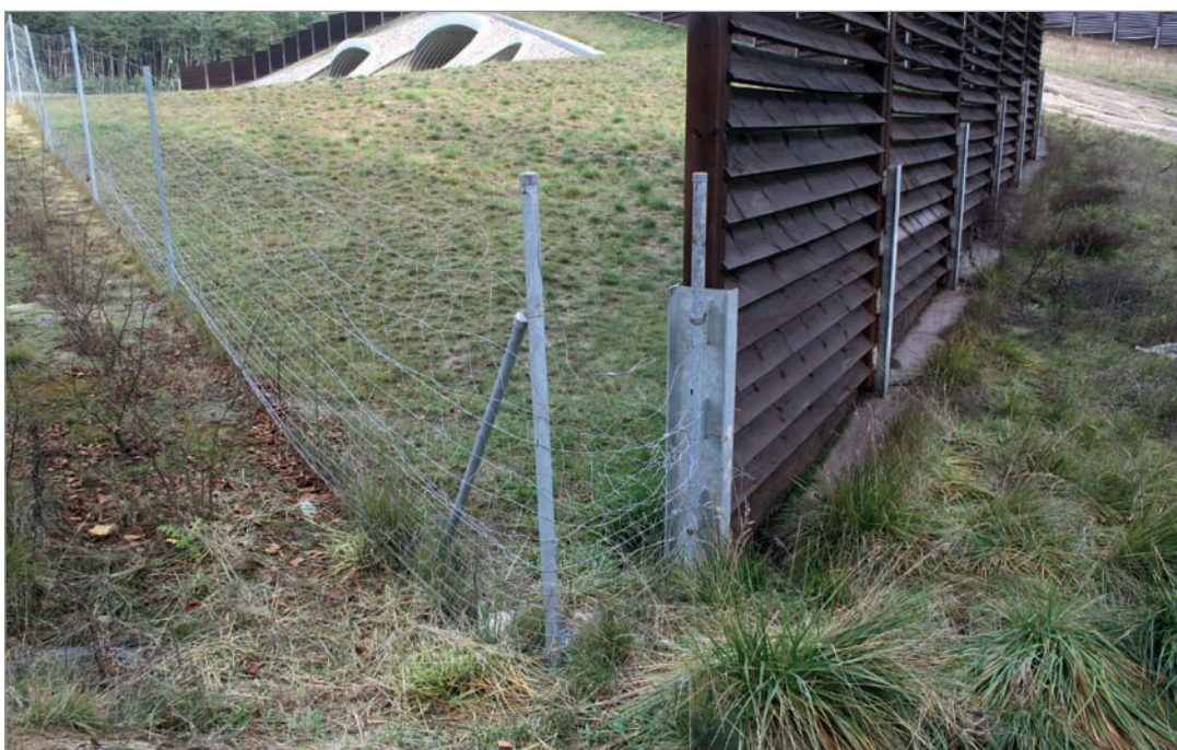
Fot. 86. Różnica wysokości i nieszczelności na połączeniu ekranu z ogrodzeniem powoduje powstanie zagrożenia przenikania zwierząt na jezdnię.
