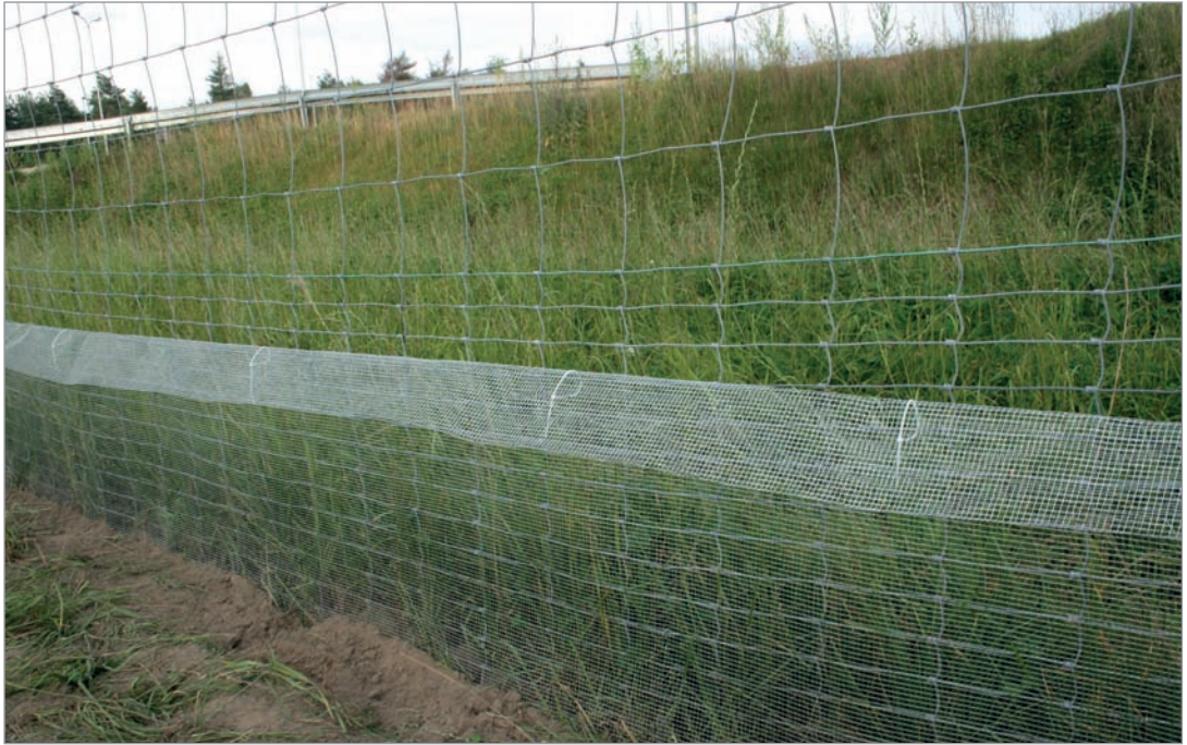
Fot. 123. Ogrodzenie ochronno-naprowadzające z siatki stalowej ocynkowanej.
