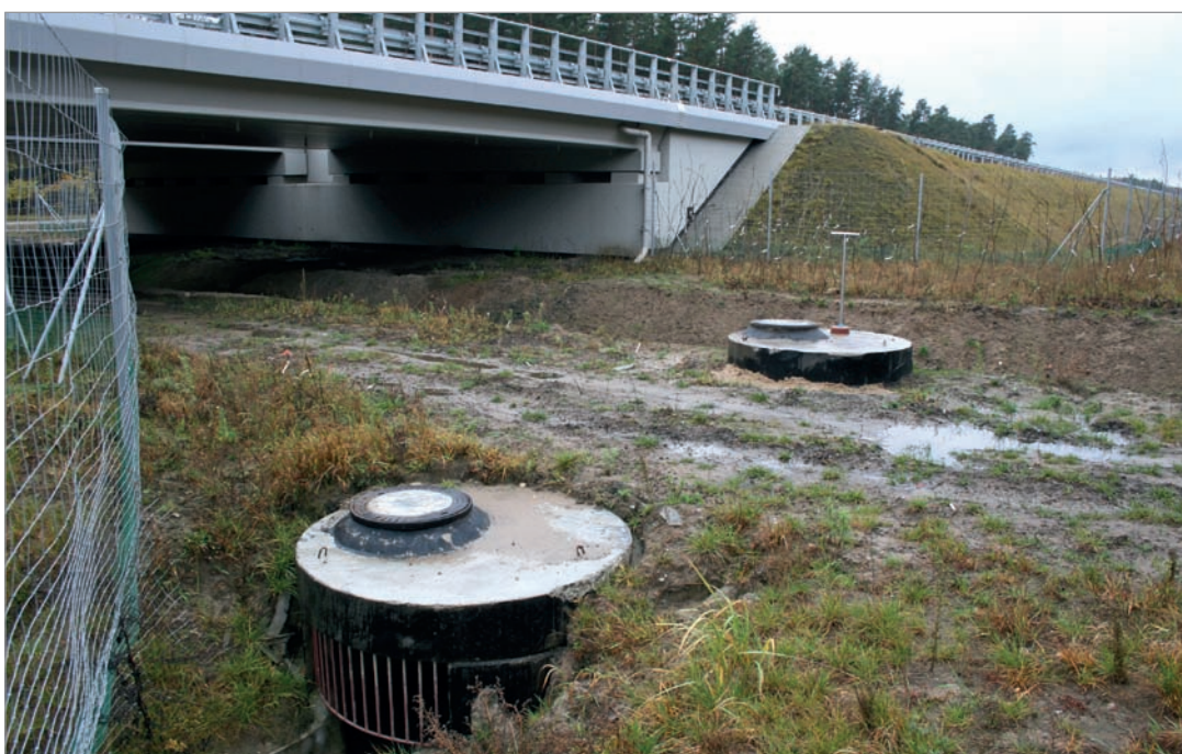
Fot. 102. Separatory utrudniające dojście do przejścia dolnego oraz stanowiące pułapkę dla płazów – droga ekspresowa S-3.
