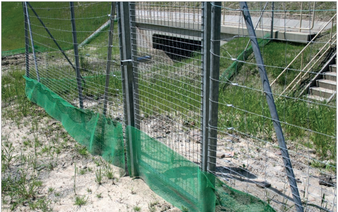
Fot. 124. Ogrodzenie ochronno-naprowadzające z siatki polimerowej (typowe usterki wykonawcze).
