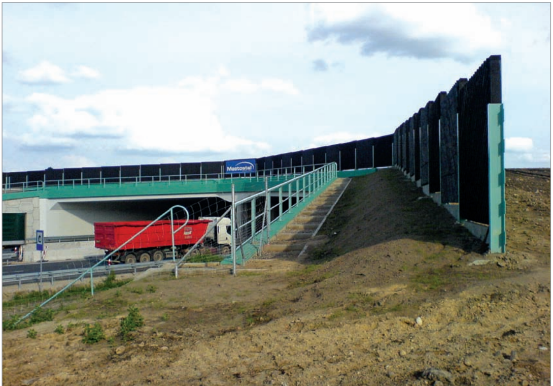
Fot. 147. Ekran zlokalizowany zbyt daleko od krawędzi przejścia górnego ograniczający jego efektywną szerokość.
