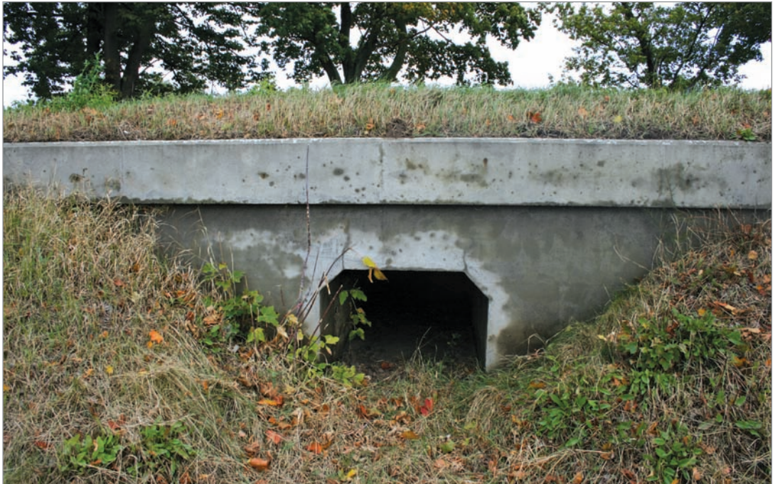
Fot. 15. Przejście dolne dla małych zwierząt – droga krajowa nr 17.
