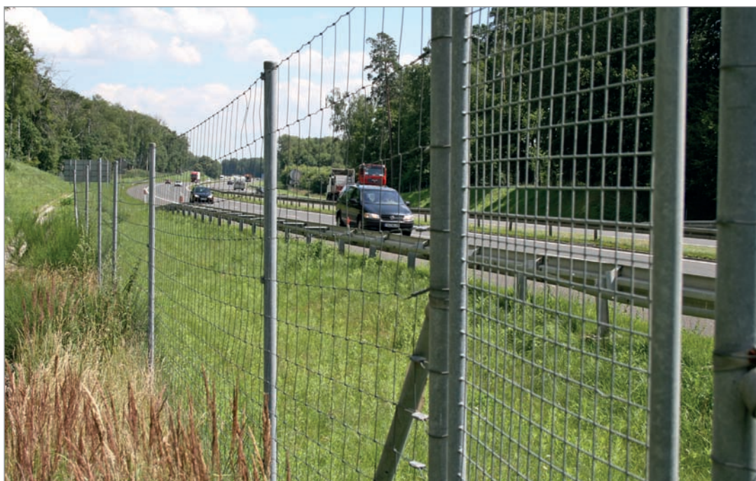
Fot. 120. Typowe ogrodzenie wykonane z siatki stalowej węzłowej (ocynkowanej) na słupkach stalowych.
