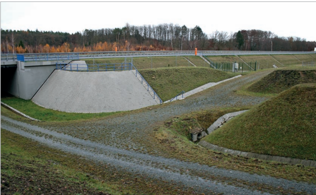
Fot. 110. Obecność wielu przeszkód utrudniających przemieszczanie się zwierząt i ogólny chaos przestrzenny w otoczeniu przejścia dolnego – autostrada A2.
