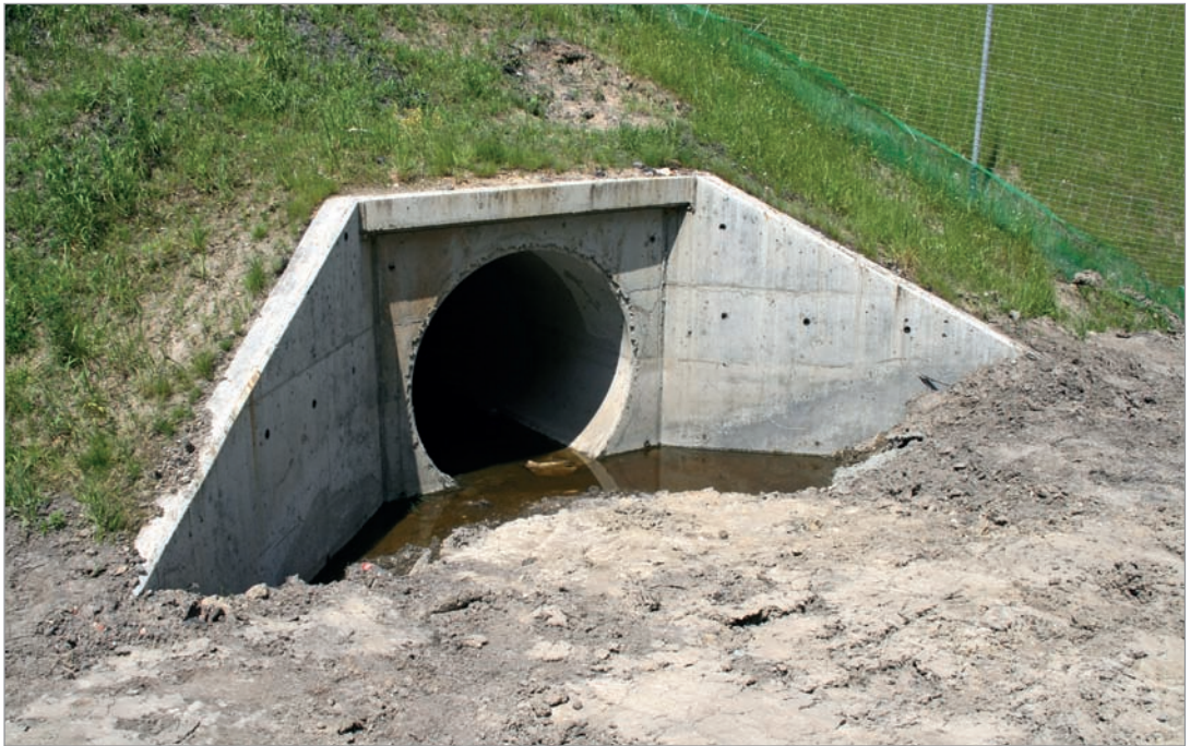
Fot. 114. W przypadku przepustów o profilu zamkniętym ich lokalizacja poniżej poziomu terenu powoduje stagnowanie wody opadowej.
