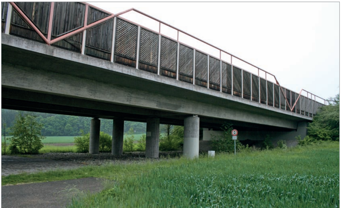
Fot. 138. Drewniany ekran pochłaniający na przejściu dolnym.
