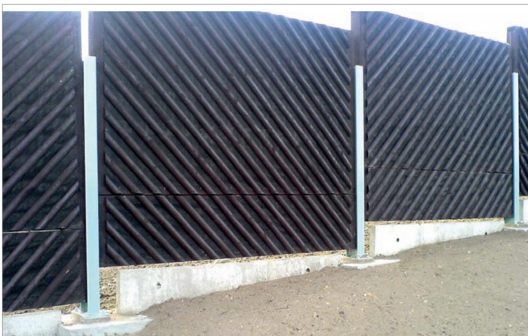
Fot. 149. Nieszczelności ekranów przy powierzchni gruntu powodują przenikanie małych zwierząt na jezdnie.
