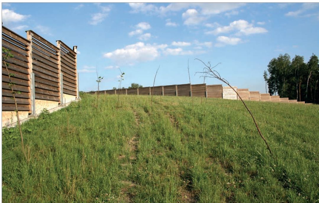
Fot. 88. Niewłaściwe zagospodarowanie powierzchni przejścia górnego – autostrada A4.
