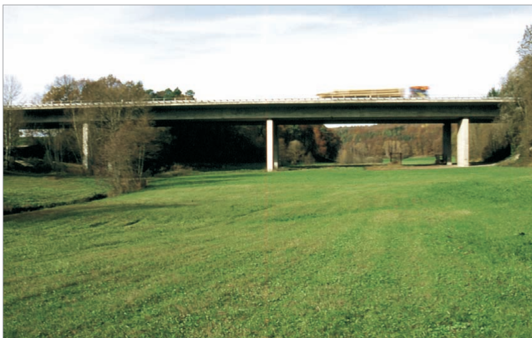
Fot. 24. Optymalne zagospodarowanie powierzchni przejścia dolnego w rozległej dolinie potoku – autostrada A98 (Niemcy).
