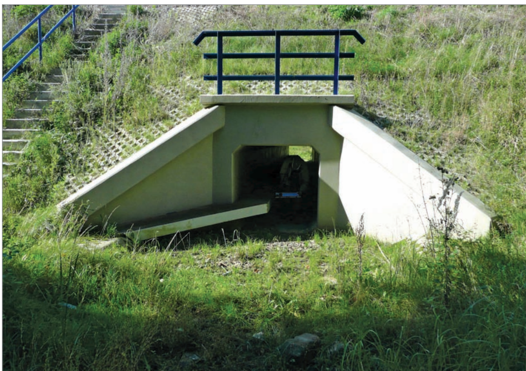
Fot. 162. Przejście dolne zespolone (z półką podwieszoną) dla małych zwierząt przy linii kolejowej Warszawa – Łódź.
