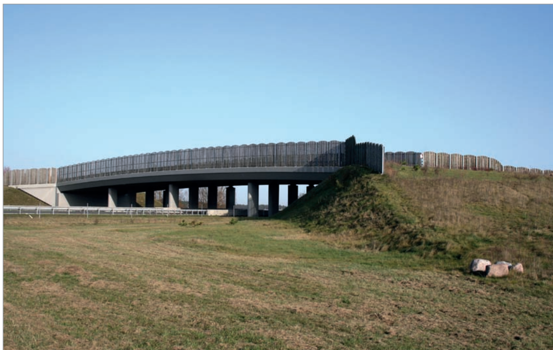
Fot. 74. Przejście o zbyt małym kącie rozwarcia najść oraz konstrukcji bez zmiennej szerokości – autostrada A2.
