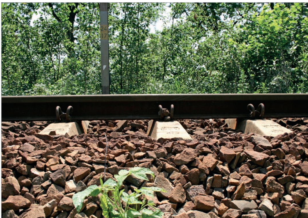
Fot. 165. Szczeliny pod szynami należy pozostawiać na każdym odcinku linii kolejowej kolidującej z siedliskami płazów.
