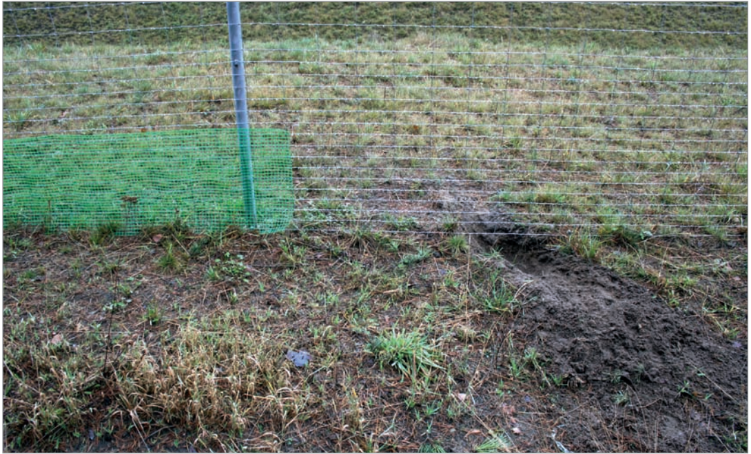
Fot. 103. Podkop wykonany przez łasicowate bezpośrednio przy zakończeniu ogrodzenia ochronnego dla małych zwierząt.
