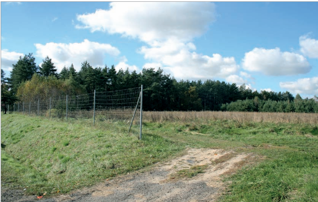
Fot. 131. Niewłaściwie zakończone ogrodzenie ochronne – droga krajowa nr 8.
