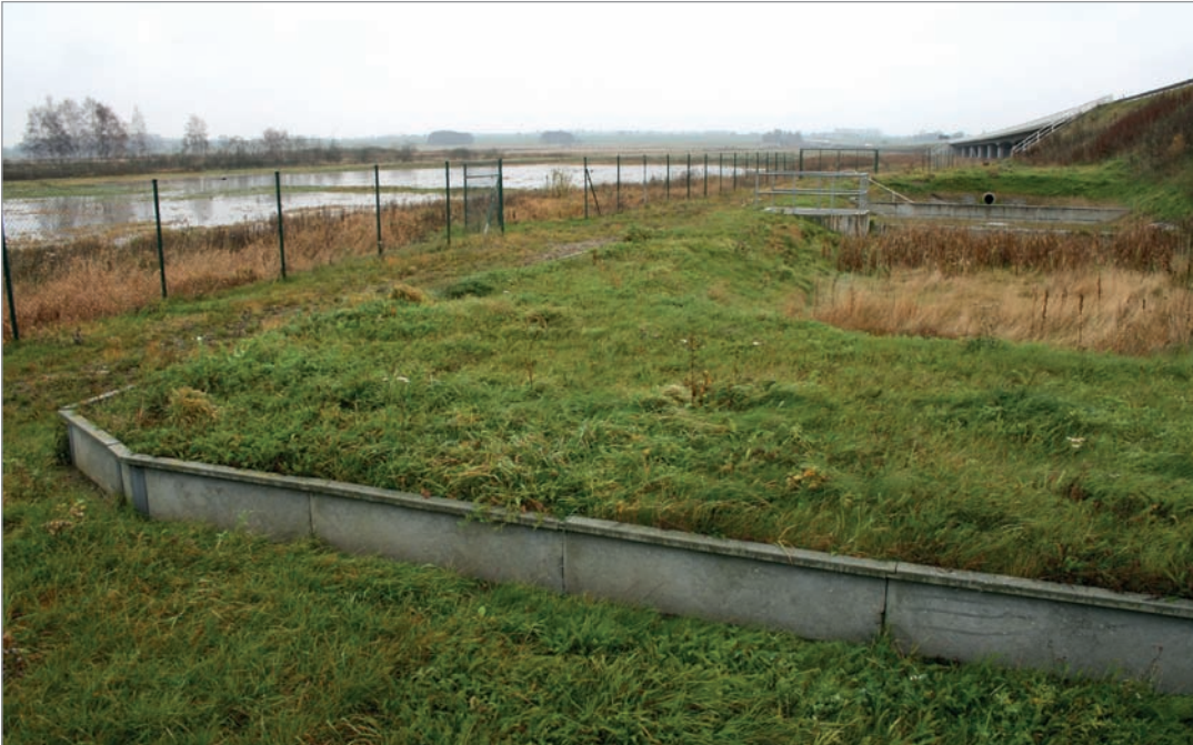
Fot. 66. Obiekty odwodnieniowe zabezpieczone ogrodzeniami (z polimerobetonu) przed wchodzeniem pławów – autostrada A20 (Niemcy).
