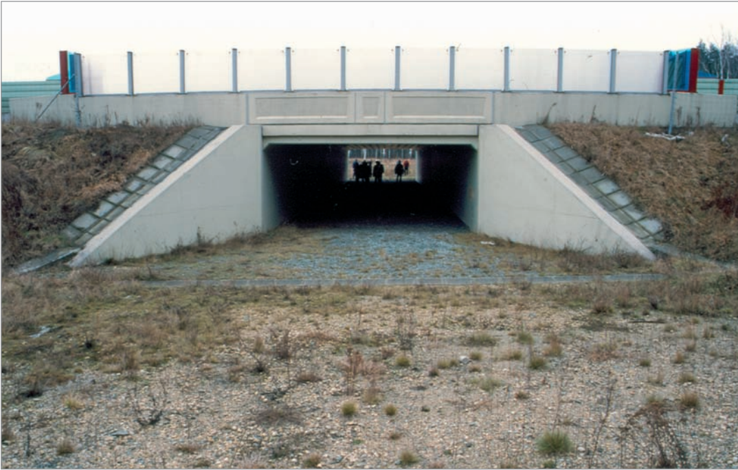
Fot. 76. Przejście dolne o wymiarach niedostosowanych do wymagań ssaków kopytnych, dodatkowo brak okna doświetleniowego – autostrada A4.
