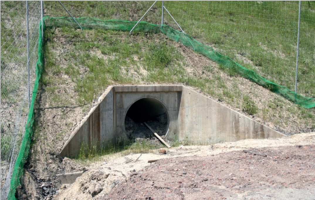
Fot. 82. Niewłaściwy, okrągły przekrój przejścia dla płazów. Zamknięty profil przepustu uniemożliwia utrzymanie odpowiedniej wilgotności podłoża – autostrada A1.
