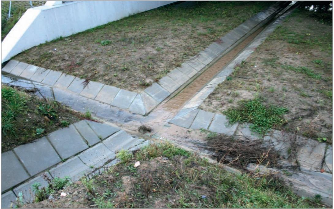
Fot. 83. Otwarte i umocnione rowy utrudniające przemieszczanie się zwierząt na powierzchni przejścia dolnego – droga ekspresowa S-3.
