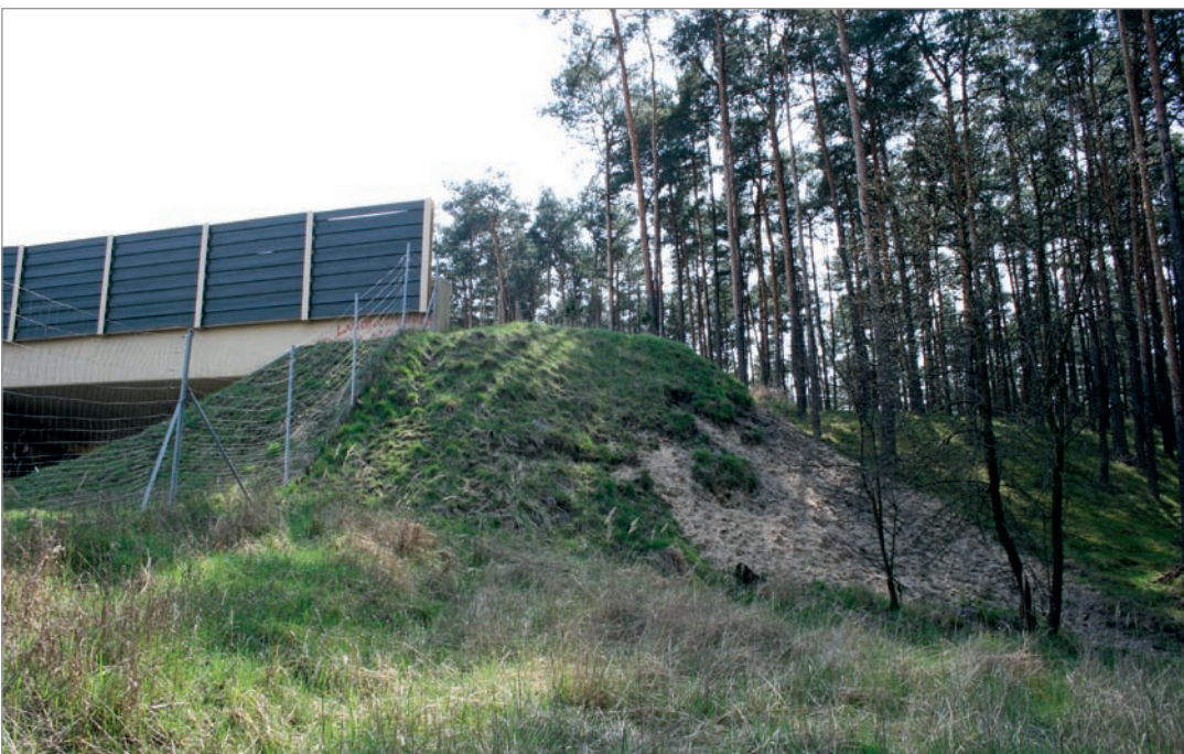
Fot. 113. Do obniżenia nominalnej wysokości ogrodzeń dochodzi zwłaszcza przy ich lokalizacji na stromych skarpach.
