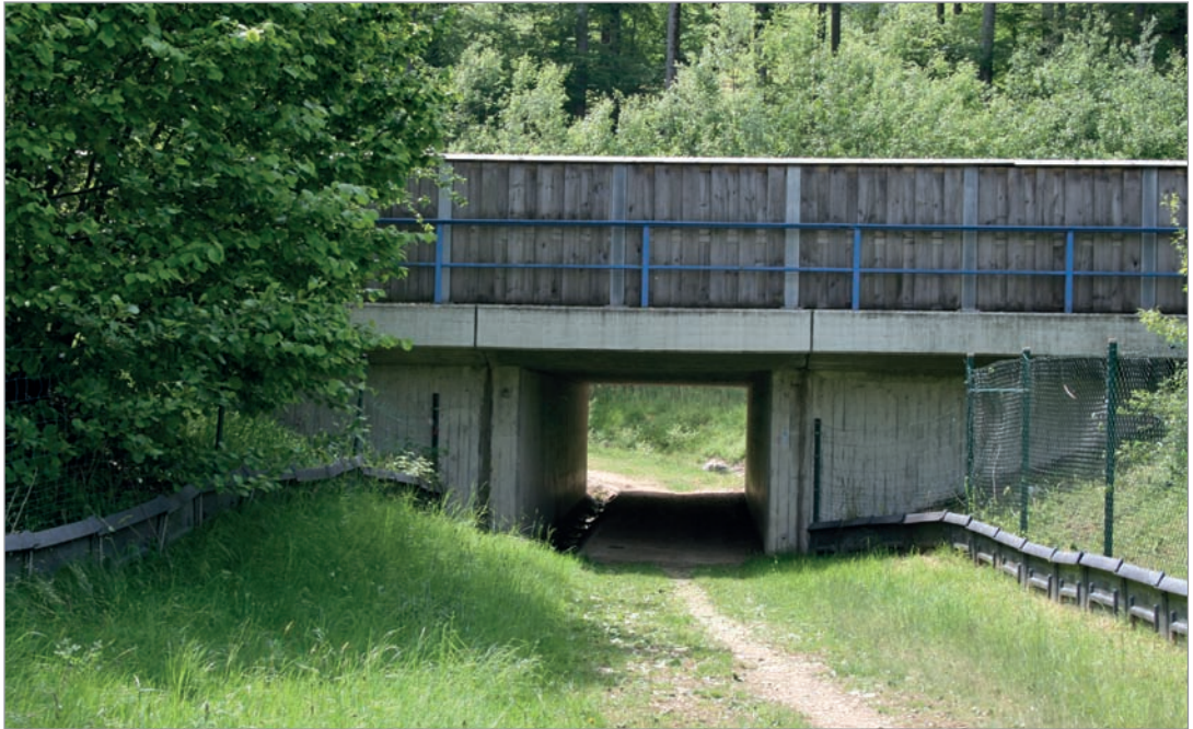
Fot. 137. Drewniany ekran odbijający na przejściu dolnym – rozwiązanie ograniczające kolizje z udziałem nietoperzy.
