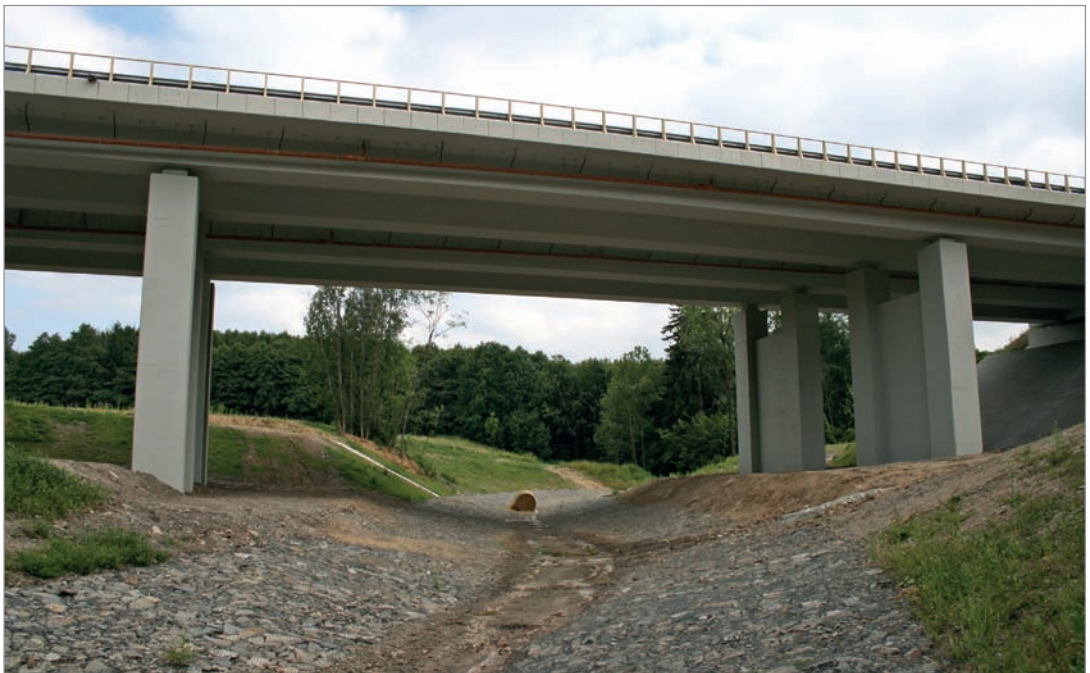
Fot. 94. Zniszczenie naturalnego koryta potoku przez umocnienia z materacy gabionowych – droga ekspresowa S-1.
