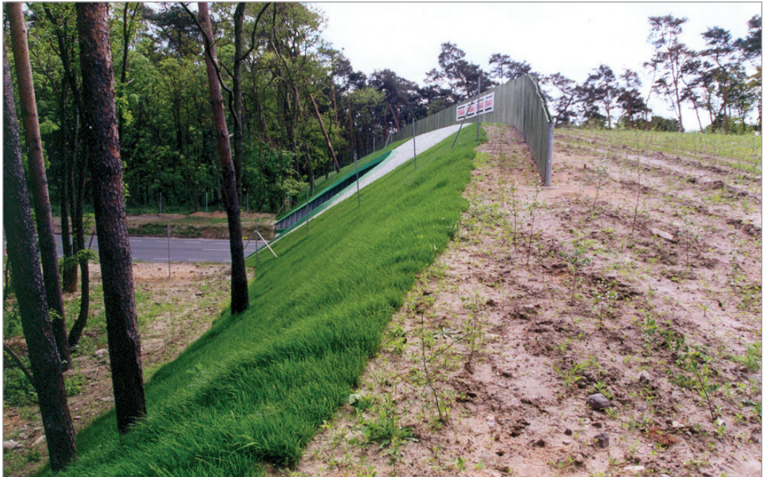
Fot. 84. Zbyt krótki i niewłaściwie zlokalizowany ekran przeciwołśnieniowy na powierzchni przejścia górnego – droga krajowa nr 5.
