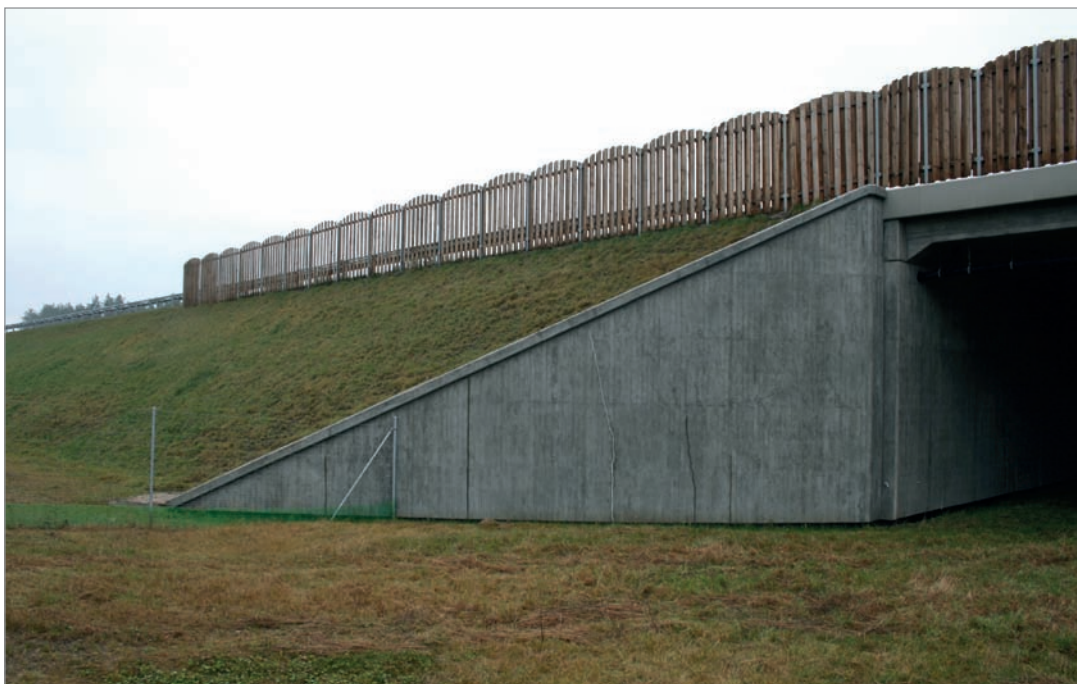
Fot. 85. Nieszczelne ekrany przy przejściu dolnym – autostrada A1.
