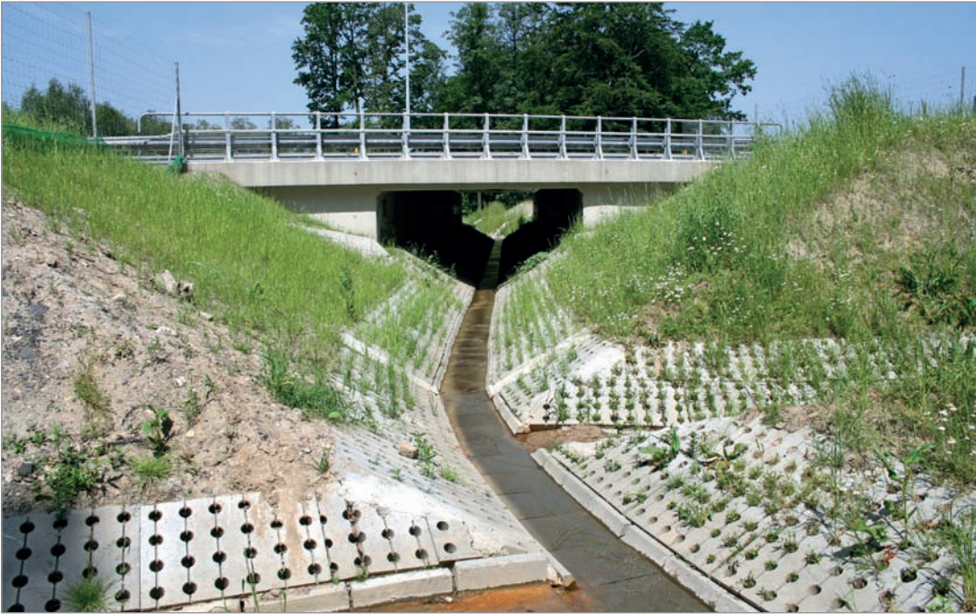
Fot. 95. Zniszczenie naturalnego koryta strumienia przez umocnienia z azurowych płyt betonowych – autostrada A1.
