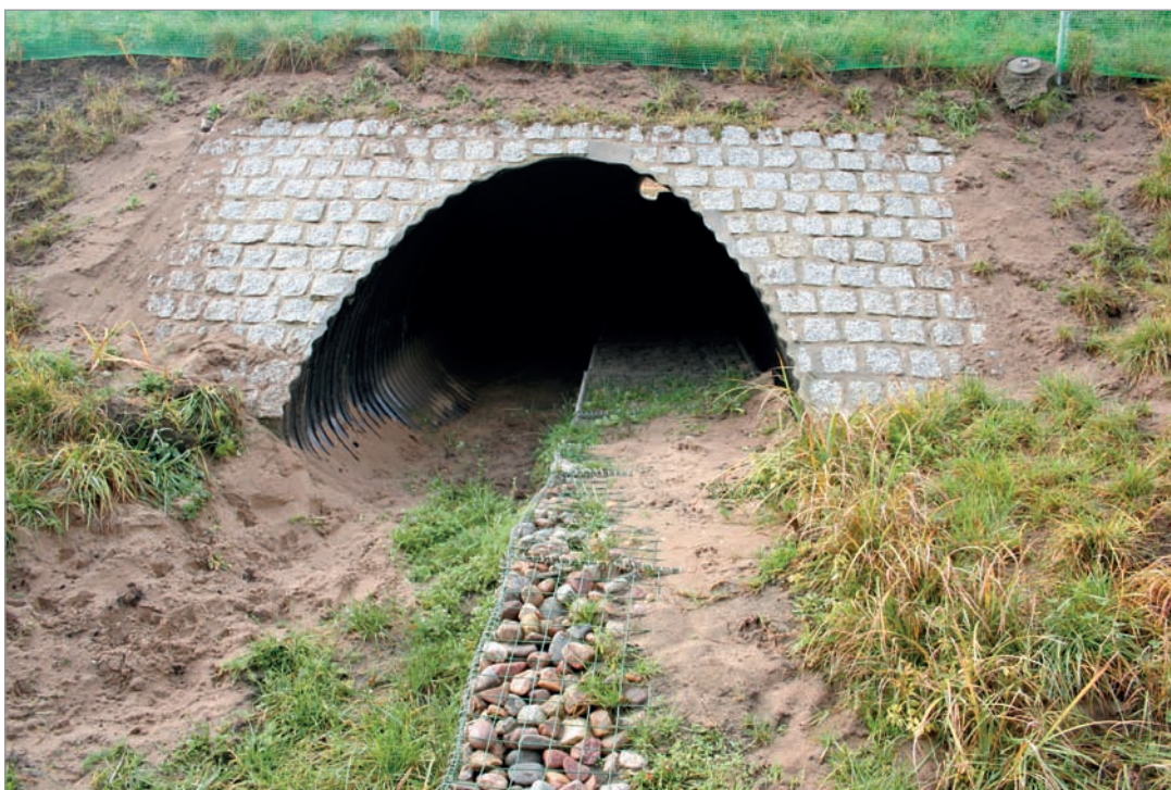
Fot. 119. Półki gabionowe niedokładnie pokryte gruntem.
