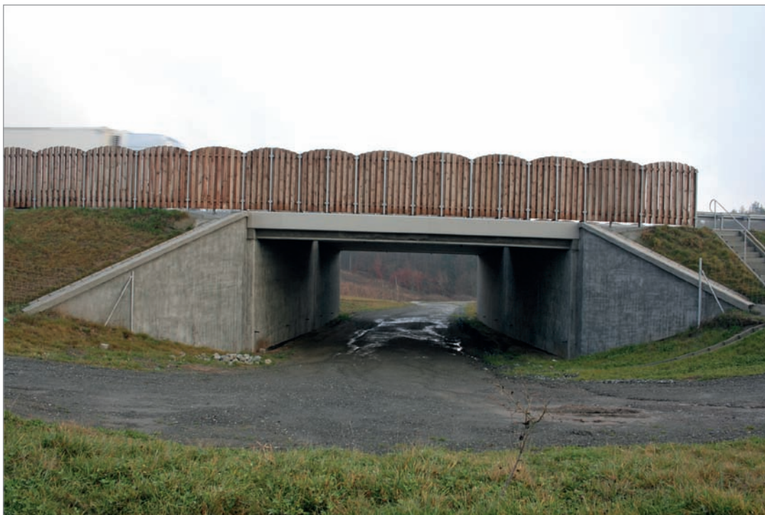
Fot. 145. Przykład przejścia dolnego o zbyt krótkich ekranach przeciśnieniowych.
