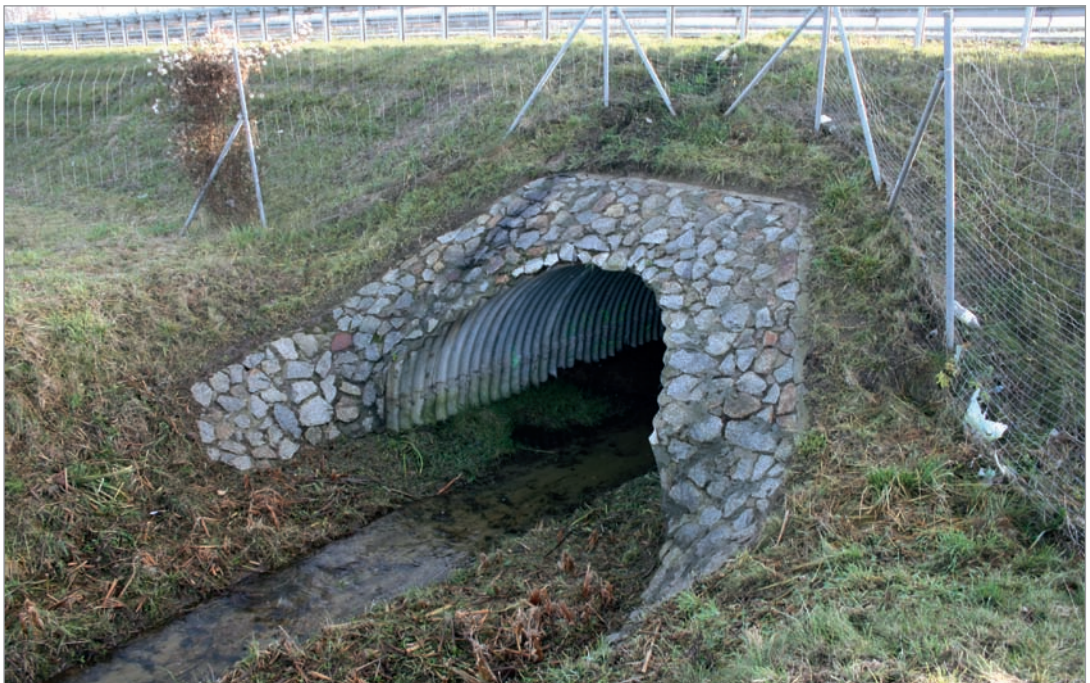
Fot. 53. Przejście dla małych zwierząt zespolone z rowem – przepust stalowy – autostrada A2.
