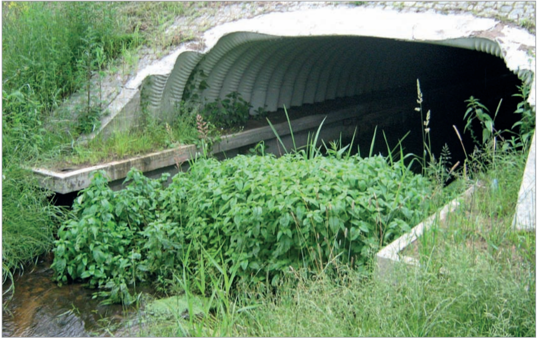
Fot. 57. Półka żelbetowa pokryta gruntem – przepust stalowy o profilu otwartym na ławach żelbetowych.
