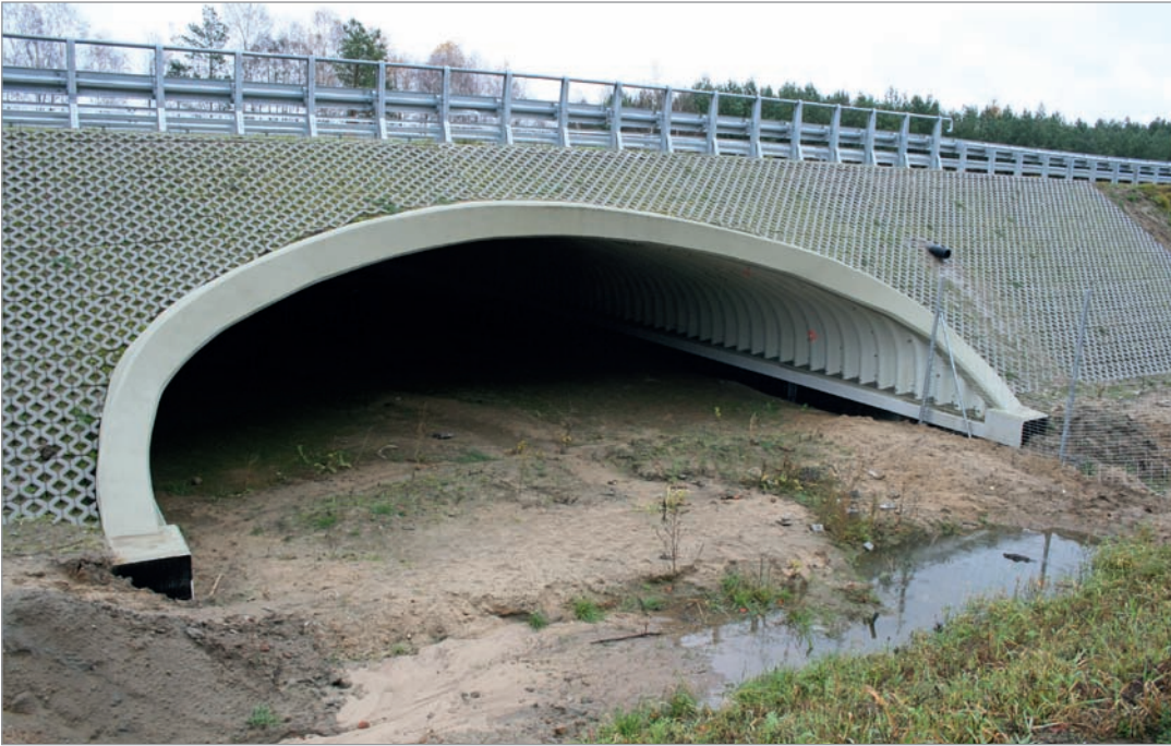
Fot. 40. Przejście dolne dla średnich zwierząt – konstrukcja z blachy falistej na ławach żelbetowych – droga ekspresowa S-3 (w budowie).
