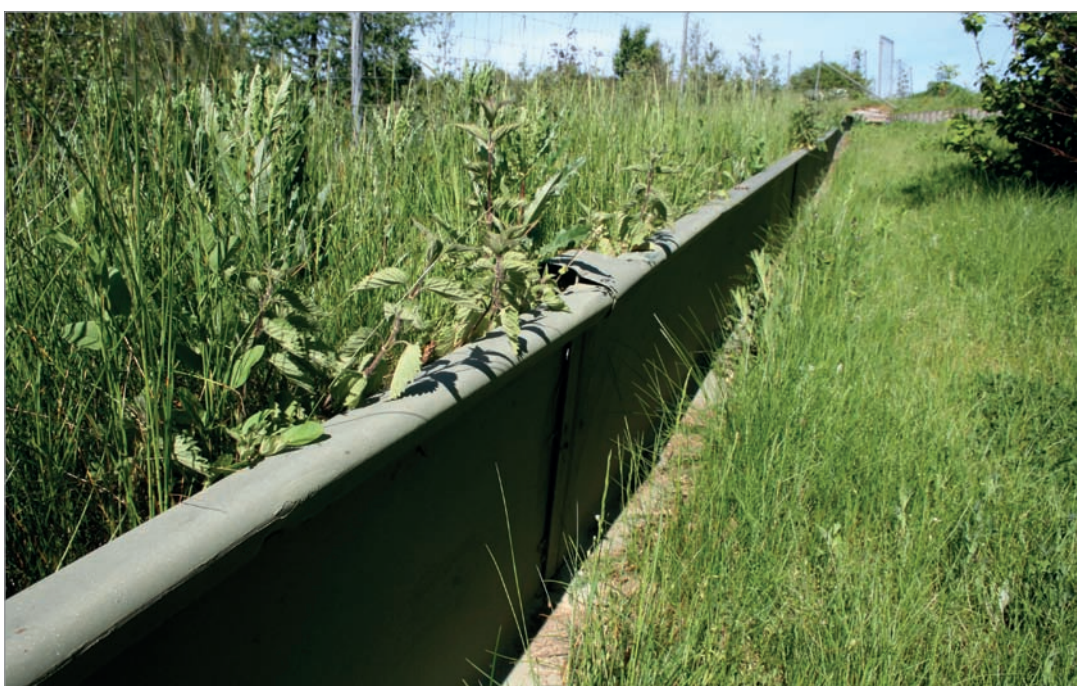
Fot. 127. Ogrodzenie ochronno-naprowadzające z płyt stalowych malowanych.
