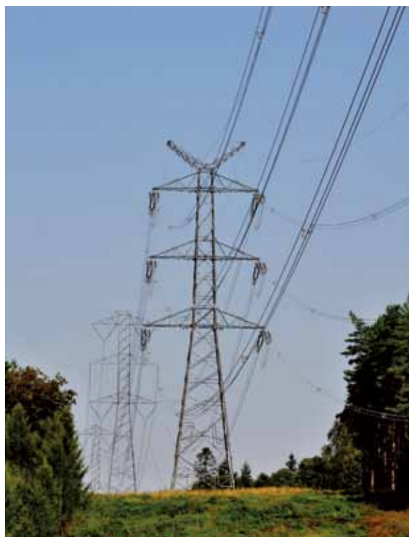
Ryc. 4.5. Okolice Przełęczy Dukielskiej. Dwutorowa napowietrzna linia elektroenergetyczna o napięciu 400 kV w terenie górskim. Szerokość pasa wycinki jest zależna od napięcia znamionowego linii i wysokości drzewostanu. Zastosowane potrójne przewody wiązkowe ograniczają poziom wyładowań niezupełnych i tym samym poziom hałasu w otoczeniu linii.
