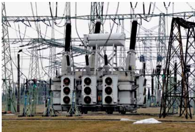
Ryc. 4.9. Duży transformator na stacji elektroenergetycznej.
